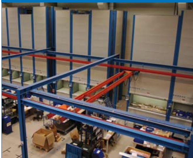
Výtahové zařízení byly dodány ve třech různých výškách.
