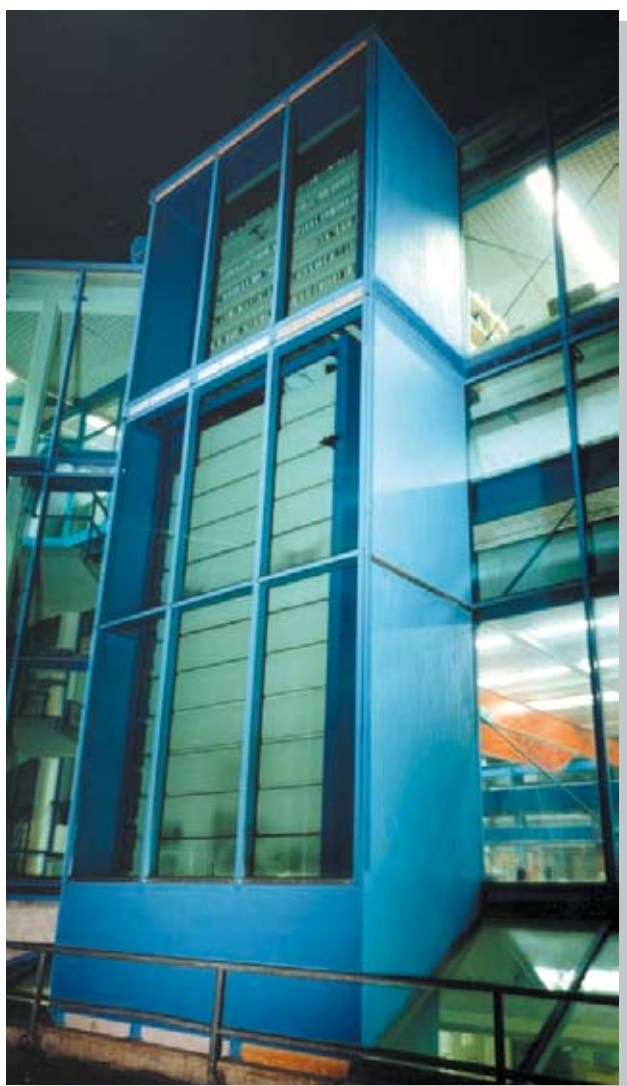
Provoz přes více pater, instalován zvenčí budovy.
